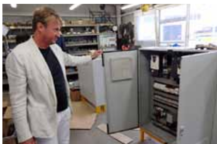
Kvalitu jeřábů vytváří i elektroinstalace a řídicí systémy na úrovni doby, konstatuje Rudolf Fišer
