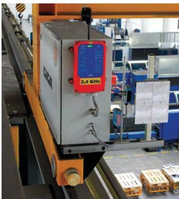
Detail pojezdu s elektrickým rozvaděčem a přijímačem RDO
